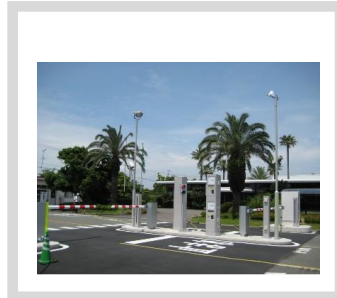
駐車場・入退管理設備監視
